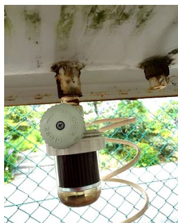
フィルターの汚れはあるものの、内部もきれいな状態のタンクでした。それでもタンクの底部分には腐食が始まっていますね。
